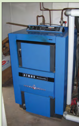
Trollheimshytta fikk installert ny fyrkjel i 2003. Automatisk trekkregulering gir redusert vedforbruk i forhold til den gamle kjelen.
