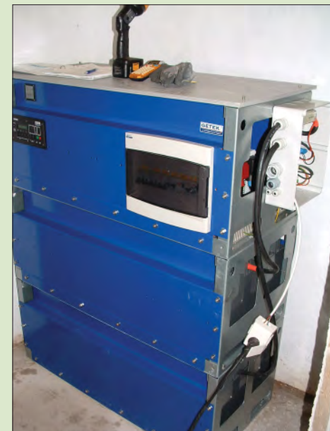
Dieselaggregatet på Storerikvollen leverer opp til 35 kW og driftstiden ønskes begrenset til ca. 8 timer /døgn. Resten av døgnet hentes energien fra en nyinnkjøpt batteribank (bildet). Foto: Odd Harald Eriksen
