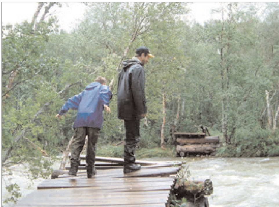
Ved Svartåa fredag 15. august er det bare å konstatere at brua er borte. Foto: Sigmund Sørgerd
